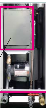
ボイラ扉内部
